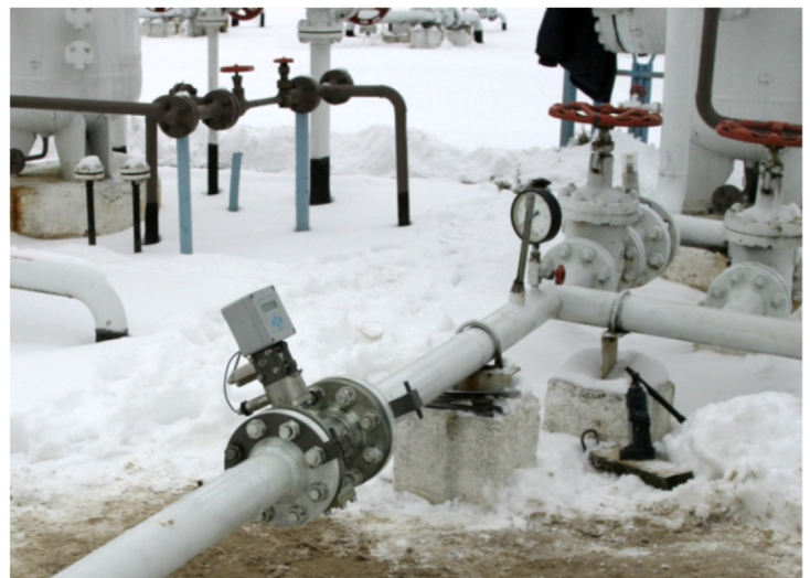
Витратомір-лічильник РГ-ОНТ в експлуатації
