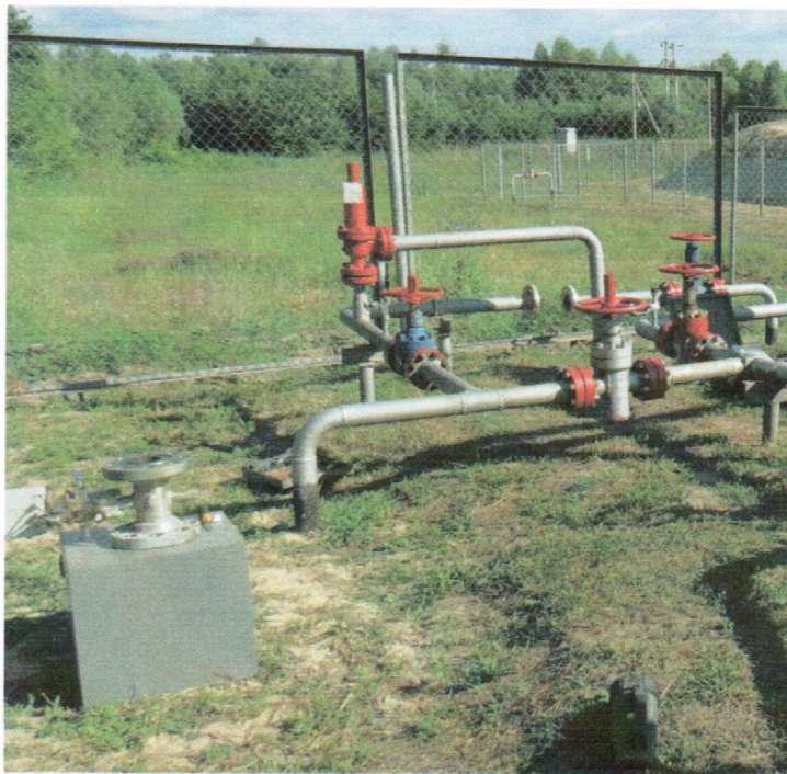
Рисунок 1 – Витратомір-лічильник газу РГ-ОНТ ВЛ-01-65-160-12 МПа зав. № 0104 демонтований з лінії замірного колектора 22.06.2017 р.
